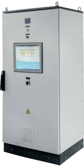
Шкаф контроллера ШК
